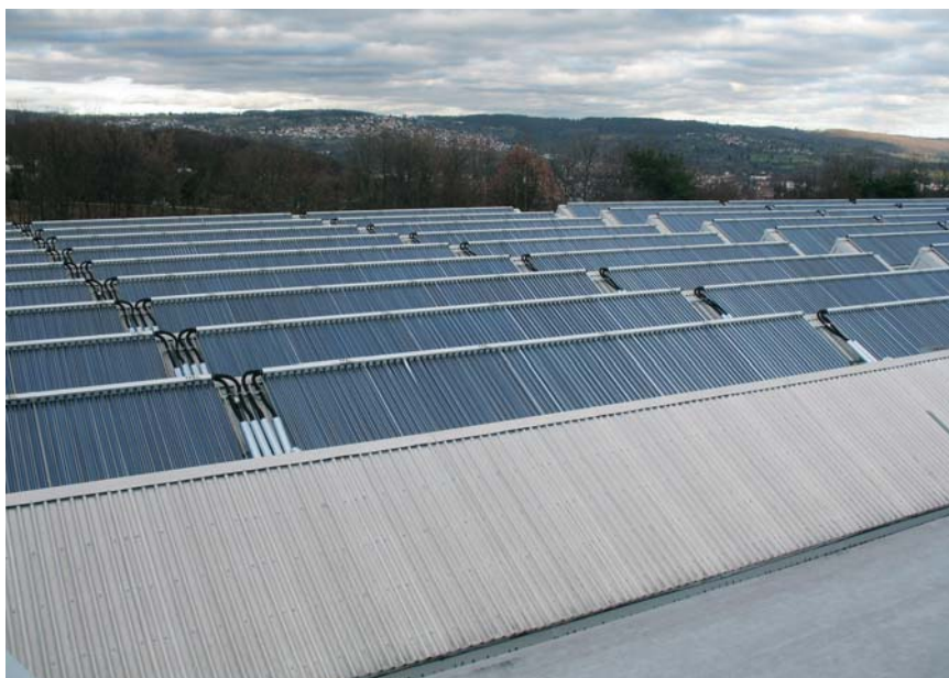
Bild 1: Sheddach mit CPC-Vakuumröhrenkollektoren
