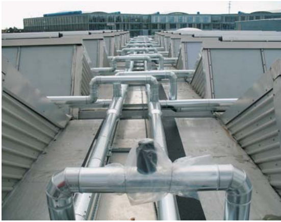
◀ Bild 2: Einfach heißt: kein einziger Entlüfter, kein Ventil, keine Stellarmatur auf dem Dach
